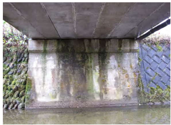
PC橋 橋台ひびわれ
