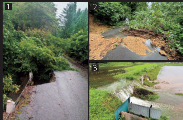
①路面が崩れた町道下前桂子沢線 ②林道小俣沢線 ③畦畔が崩れた泉沢区の水田
