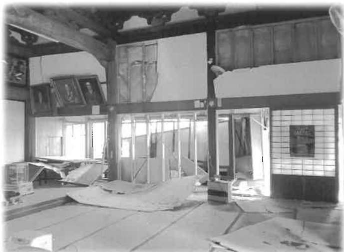
壁が崩落した玉蓮寺本堂3.11当時の様子
