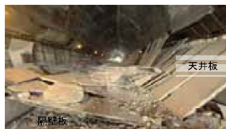
写真-4 天井板崩落状況②
