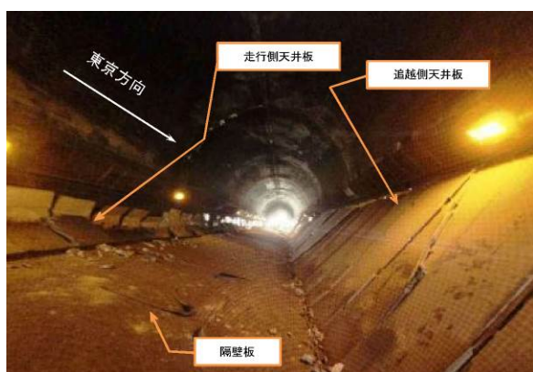
写真-3 天井板崩落状況
