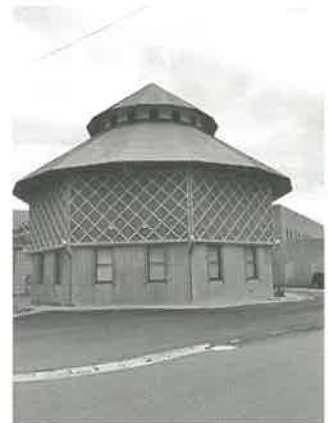
屋根塗装が必要な U ホール
