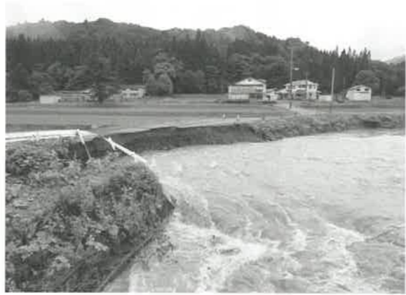
大雨による町道阿津裏線(猿橋地区)道路災害
